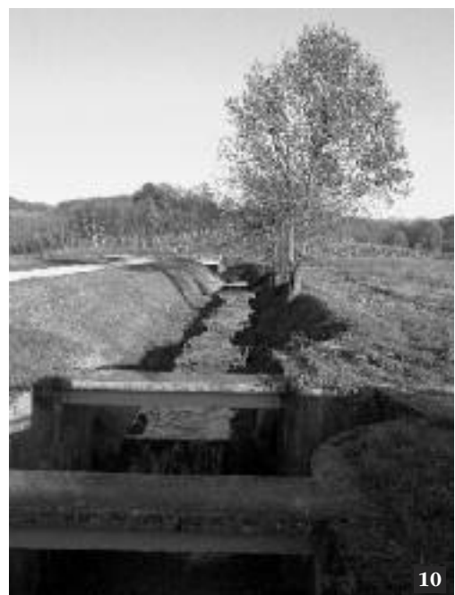
Piana del Preval. Torrente Barbuscina. Canalizzazione.
